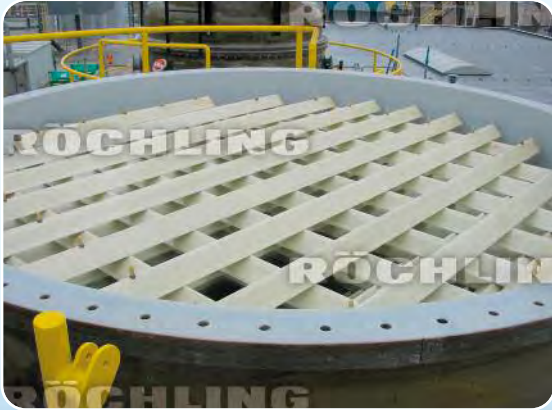
Plantas de desulfuración de gases de combustión Flue gas desulphurization plant
